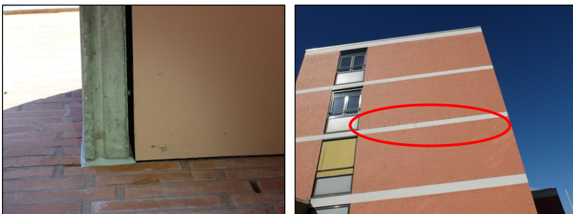
Figuur 11 Links: Ruimte tussen beton en betimmering; Rechts: Open stootvoegen
