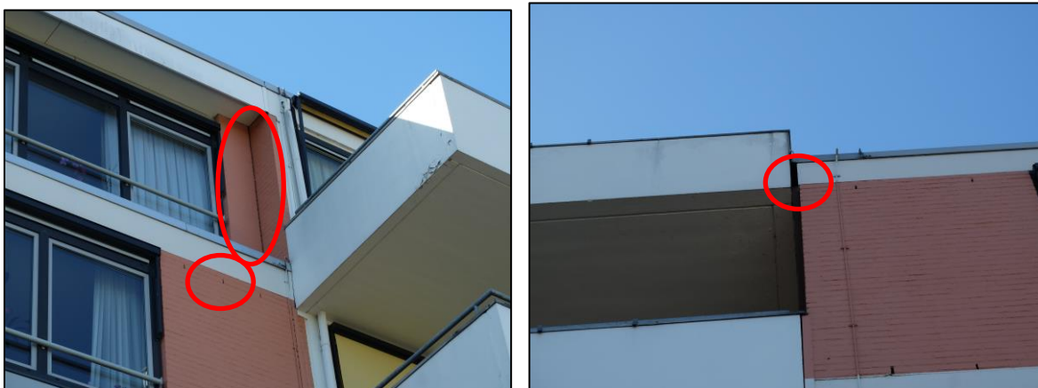
Figuur 10 Links: Open stootvoegen en open dilatatievoeg; Rechts: Opening tussen het balkon en de muur
