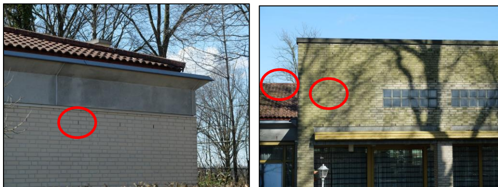
Figuur 12 Links: Open stootvoegen; Rechts: Open stootvoegen en ruimte tussen de gevelpannen
