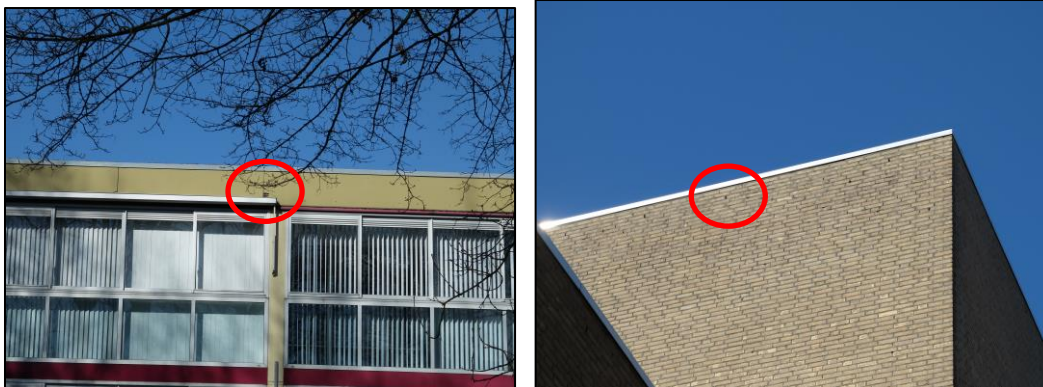
Figuur 9 Links: Glazen wand met betimmering; Rechts: Open stootvoegen en zinkenrand
