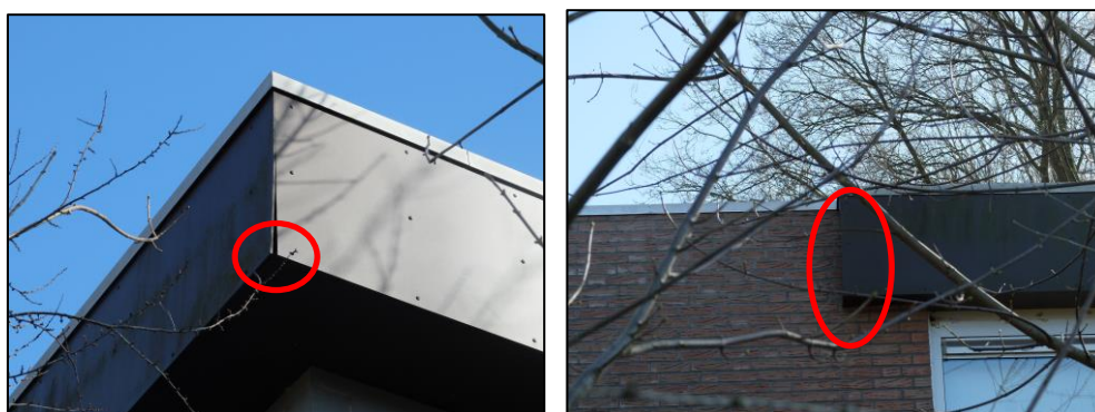
Figuur 13 Links: Openingen in de betimmering; Rechts: Openingen tussen de muur en de betimmering
