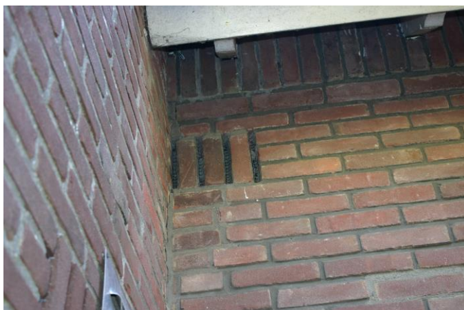
Figuur 4.5.1. De ventilatiesleuven zijn afgedicht met gaas.
