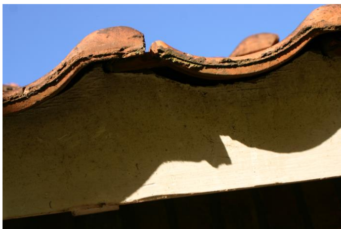
Figuur 4.5.3. De lat onder de onderste rij dakpannen voorkomt dat vogels het dak in kunnen.
