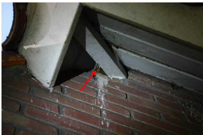
Figuur 4.5.2. Opening onder het dak (rode pijl) met vogeluitwerpselen, maar zonder vogelnest.
