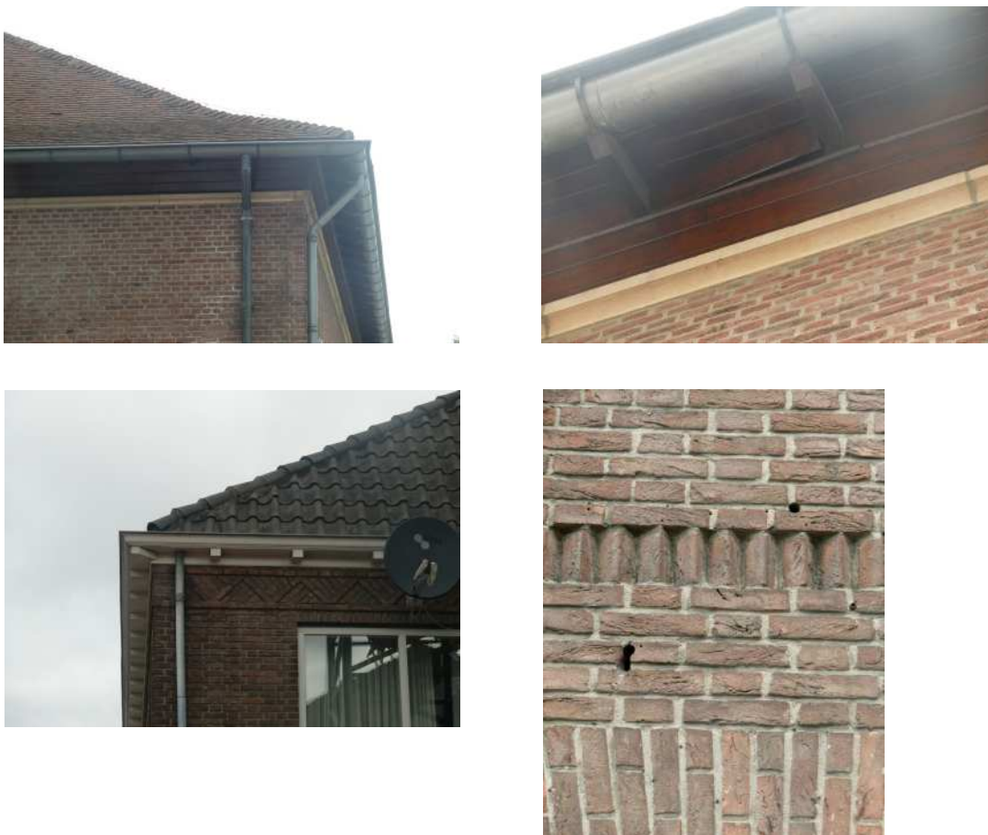
Afbeelding 5.6. Linksboven: dakrand Raadhuisstraat nr. 4, Rechtsboven: dakrand Raadhuisstraat nr. 4 met potentiële nestlocatie/verblijfslocatie, linksonder: dakrand Raadhuisstraat 2a en 2b, rechtsonder: gaten in de muur Raadhuisstraat 2a en 2b.
