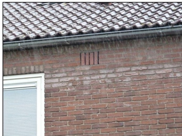
Figuur 14. Ventilatieopeningen in spouwmuur
