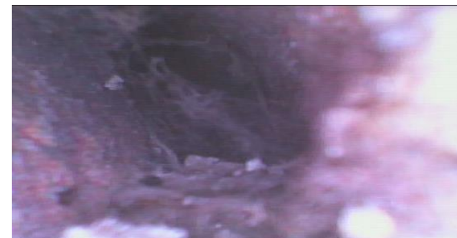
Figuur 5: Isolatiemateriaal en spinrag achter de open stootvoegen
