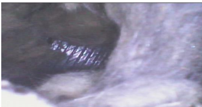
Figuur 6: Isolatiemateriaal achter de open stootvoegen
