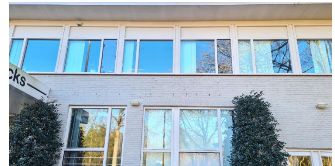
Figuur 6: Detail openstootvoegen gevel aan de Hoevenessestraat
