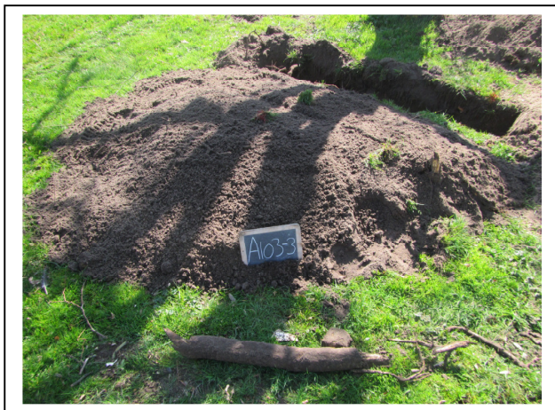
Foto 3. Asbest sleuf A103-3
