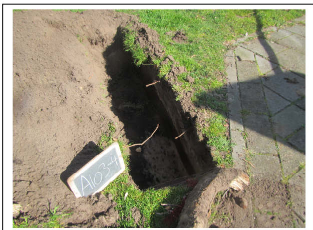
Foto 5. Asbest sleuf A103-4
