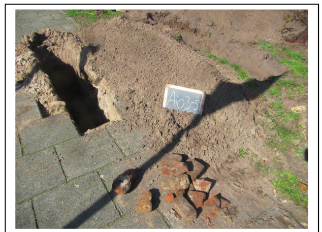
Foto 6. Asbest sleuf A103-5
