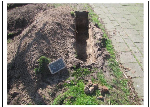
Foto 2. Asbest sleuf A103-2
