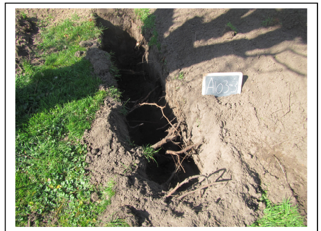
Foto 4. Asbest sleuf A103-3
