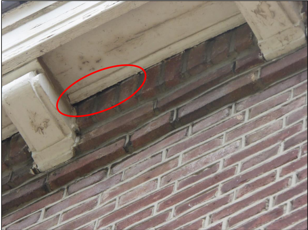
Aanwezige kieren onder de dakranden van het oude schoolgebouw.
