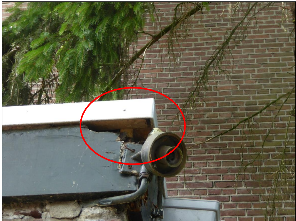
Aanwezige kier in te slopen gedeelte van de directeurswoning.
