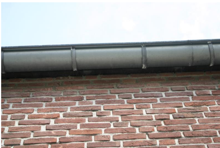
Figuur 4.2.2. De dakgoten sluiten niet nauw aan op de gevel.
